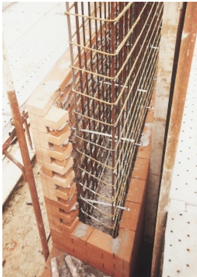
Legatura tra l'armatura verticale del setto in calcestruzzo con i graffiaggi della muratura.
