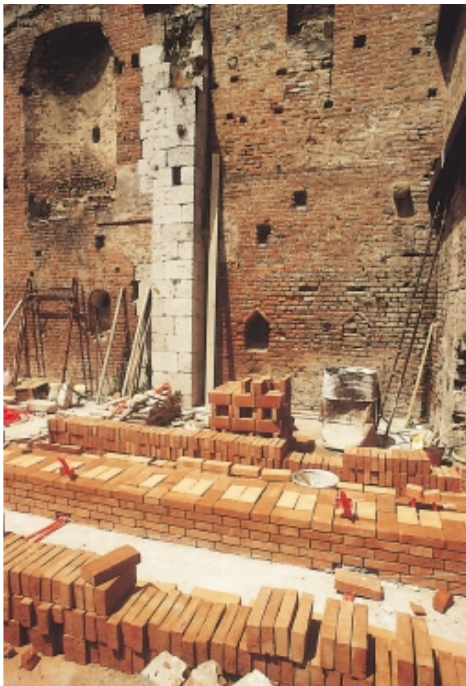
Un'attenta pulizia del cantiere è indispensabile a garantire la buona riuscita dell'impiego di elementi di laterizio faccia a vista.
