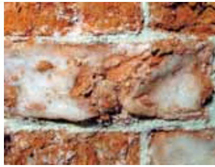
Nel caso di una efflorescenza particolarmente forte è addirittura possibile distinguere i cristalli.
