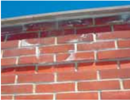
Particolare di una muratura interessata dalla presenza di efflorescenze saline.
