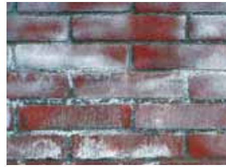
Muratura faccia a vista con diffusi fenomeni di efflorescenza.
